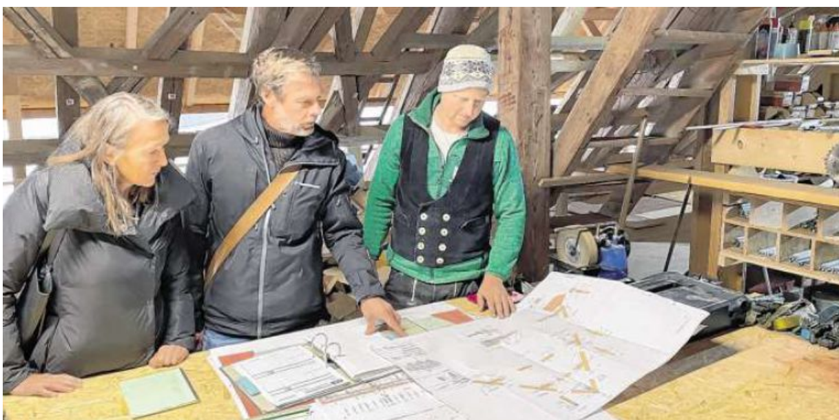
Es gibt viel zu besprechen auf der Baustelle in Deutschlands größter barocker Klosteranlage. Im Bild diskutieren über den Bauplänen (von links): Cornelia Bodenstab, Ralf Gehrke und Zimmermeister Stefan Helchenberg.
