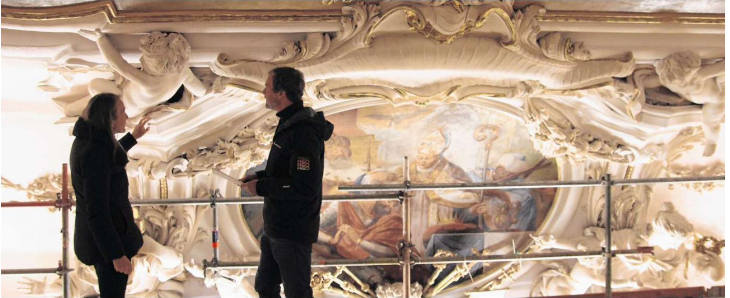
Die Leiterin des Staatlichen Bauamts Kempten, Cornelia Bodenstab, und Mitarbeiter Ralf Gehrke begutachten ganz oben auf dem Baugerüst die Schäden an den Kunstwerken der Kaisersaaldecke. Fotos: Brigitte Hefele-Beitlich (4), Markus Raffler
