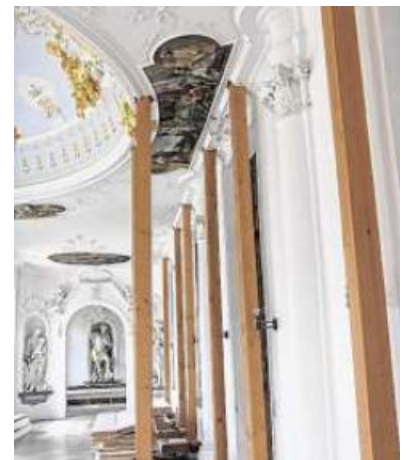
Die Vestibüldecke vor dem Kaisersaal hat sich um 13 Zentimeter gesenkt.
